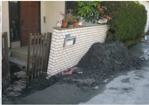
ブロック塀が右側へ大きく沈下し、傾いています。
