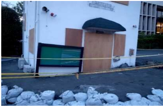
右側へ大きく沈下し、傾いています。
