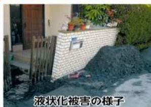
液状化被害の様子
